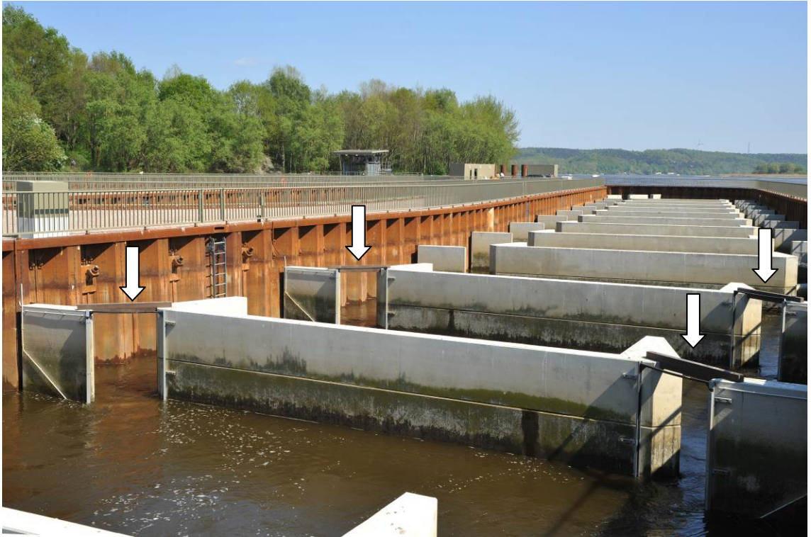
Abb. 10: Antennen im Doppelschlitzpass zur vollautomatischen Registrierung transponierter Fische (Quelle: Institut für angewandte Ökologie)
